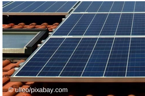
Solarmodul mit 60 polykristallinen Solarzellen
